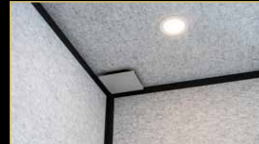
Ventilation et éclairage
